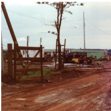
Figura 1: Entrada do depósito provisório em construção Fonte: Telma Camargo da Silva (Foto: 1987)
