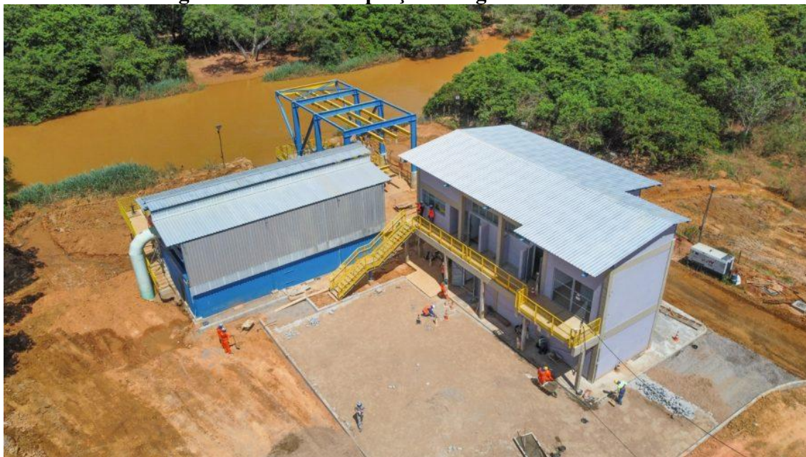
Imagem 4 – Platô de captação de águas do rio Corrente
