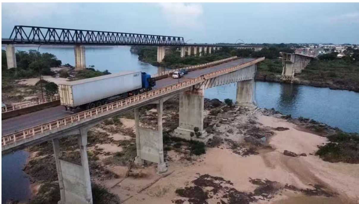
Foto: Francisco Sirianno/Grupo Mirante ( https://g1.globo.com/to/tocantins/noticia/2024/12/26/ponte-que-desabou-foi-construida-em-1960-passou-por-reparos-em-1998-e-precisava-de-novas-obras-veja-historico-da-estrutura.ghtml )
