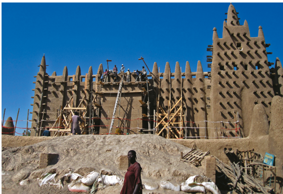
Figura 5 Parte da fachada leste da mesquita de Djenné, que desabou durante a restauração do Agha Khan Trust for Culture . Foto: Charlotte Joy.
